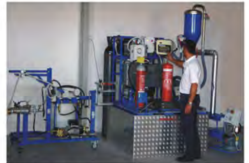
schid officina mobile manutenzione estintori.
