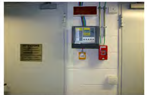
_impianto spegnimento incendio; locale CED.
