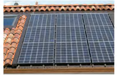
_pannelli fotovoltaici integrati
