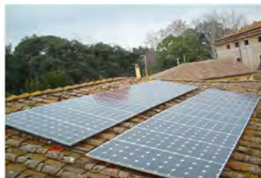
_dettaglio di pannelli fotovoltaici integrati
