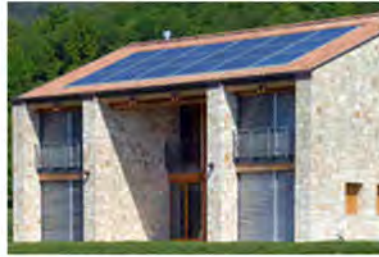
_pannelli fotovoltaici integrati
